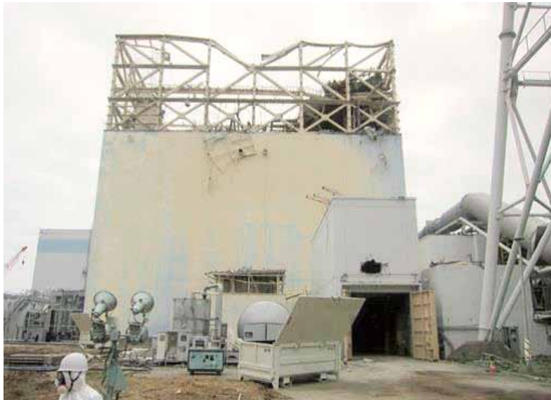
【福島第一原子力発電所1号機】 （撮影：福島県災害対策本部）
