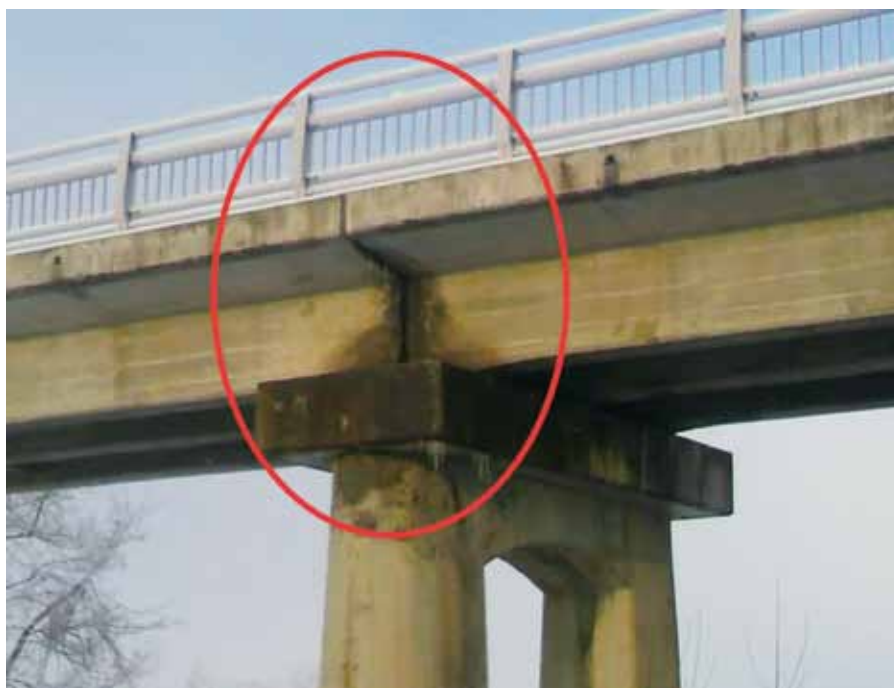
【一般県道天童河北線乱川橋の被災状況（つなぎ部損傷）】
