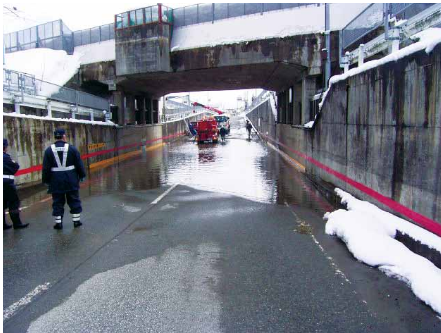
【一般国道344号宮町アンダーパス（路面冠水）】
