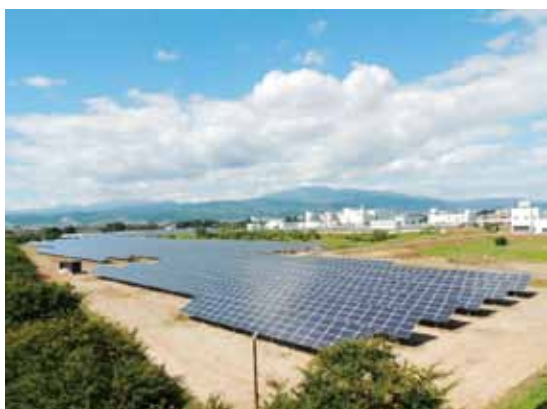
【山形浄化センター】
