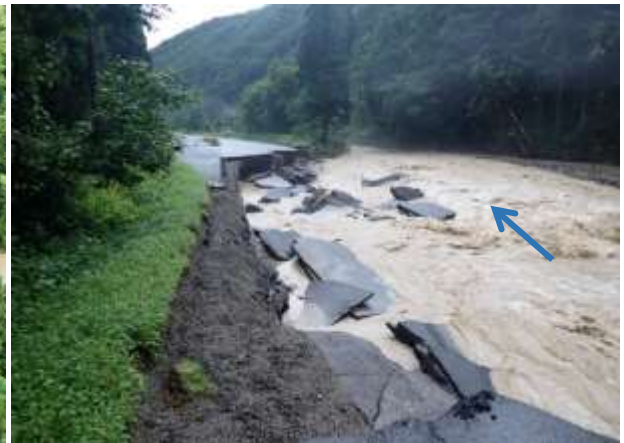
一般国道121号道路流出状況(福島側)
