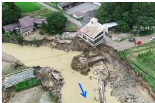
(主)長井飯豊線 大巻橋 橋梁流出状況
