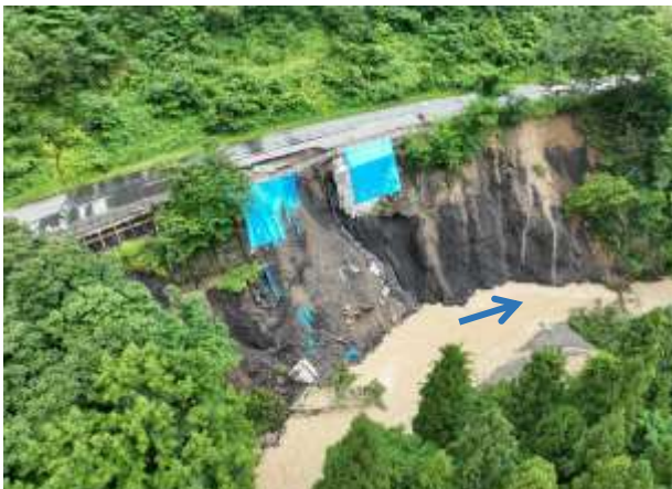
一般国道121号法面崩落状況(山形側)
